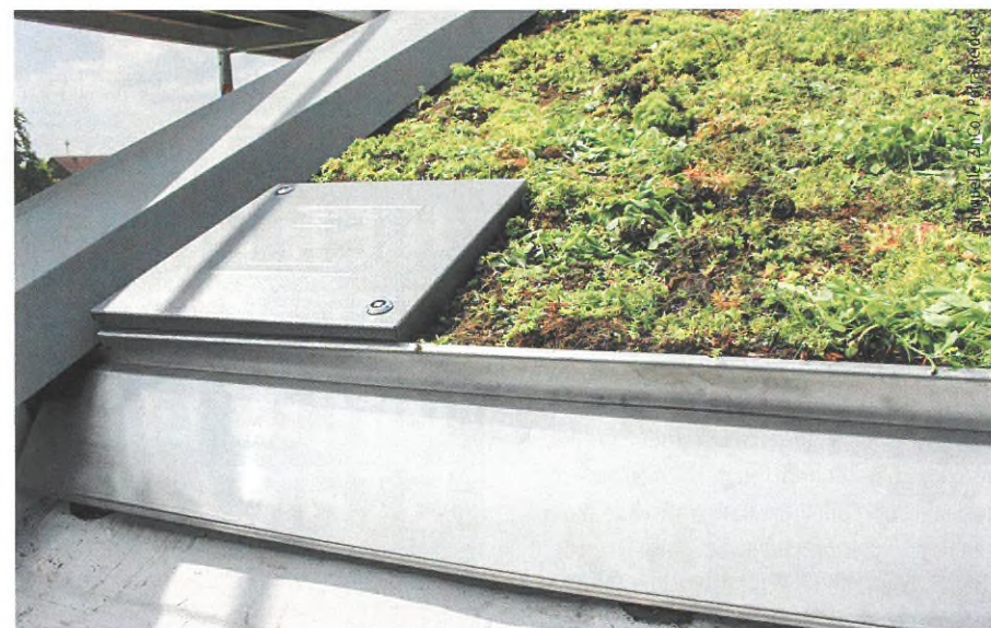
Das Traufprofil ist mit einem anthrazitfarbenen Blech verblendet und der Kontrollschacht unauffällig in der Ecke platziert.
