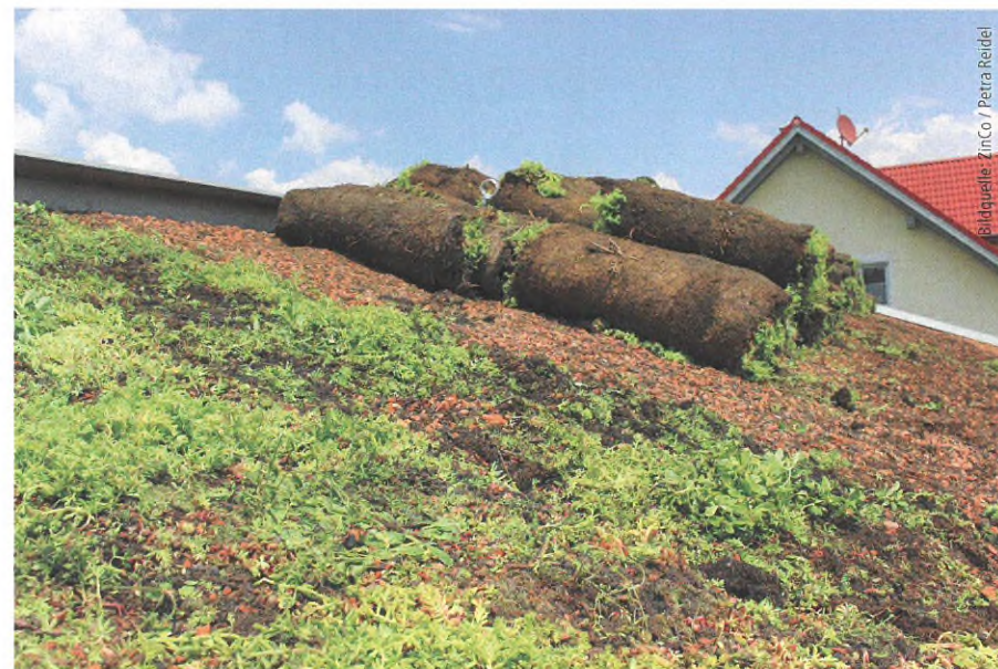
Das Ausrollen der Vegetationsmatten, die nach dem Abladen zuerst am First entlang verteilt wurden, geht sehr zügig. Die obere Sicherung mittels Kabelbinder hat sich bewährt.
