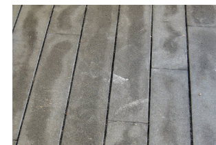
Verfärbungen am Rand und in der Fläche oder Ausblühungen machen die Arbeit zunichte – ob sich Stein und Mörtel vertragen, kann eine Probeverlegung klären. Foto: Walter Mauer
